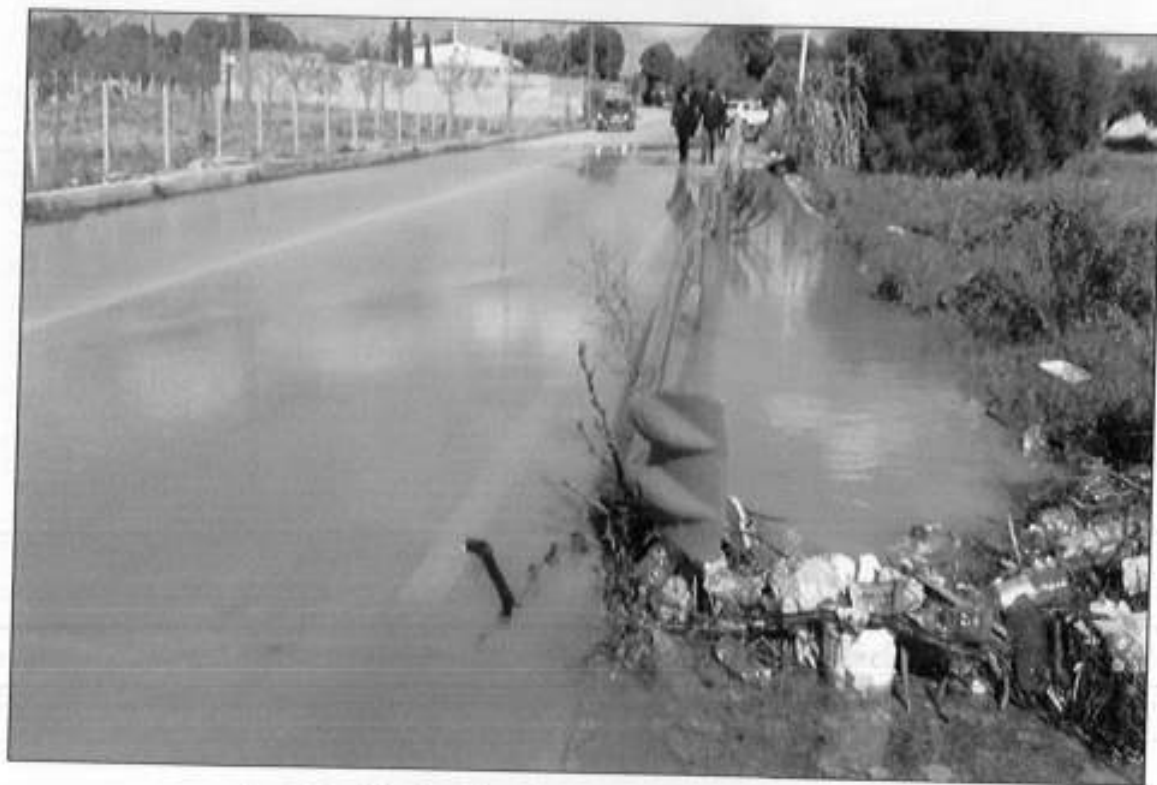
Foto 6 – Canale di scolo acque piovane SS. 115 Dir.
