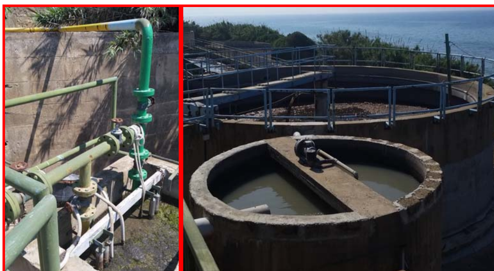
Figura 5 - Impianti in pressione e vasche.
